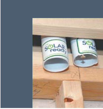
Deux conduits de plastique reliant le toit au sous-sol permettront un jour d'y passer du câblage électrique et de la tuyauterie à peu de frais. © RNCAN
